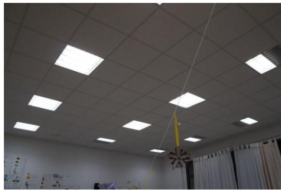
Figura 4.14 - Particolare dei corpi illuminanti ubicati all'interno di un'aula
