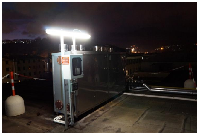
Figura 4.10 - Particolare del generatore di calore installato in copertura
