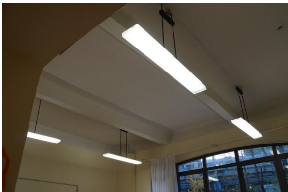
Figura 4.13 - Particolare dei corpi illuminanti ubicati nel refettorio
