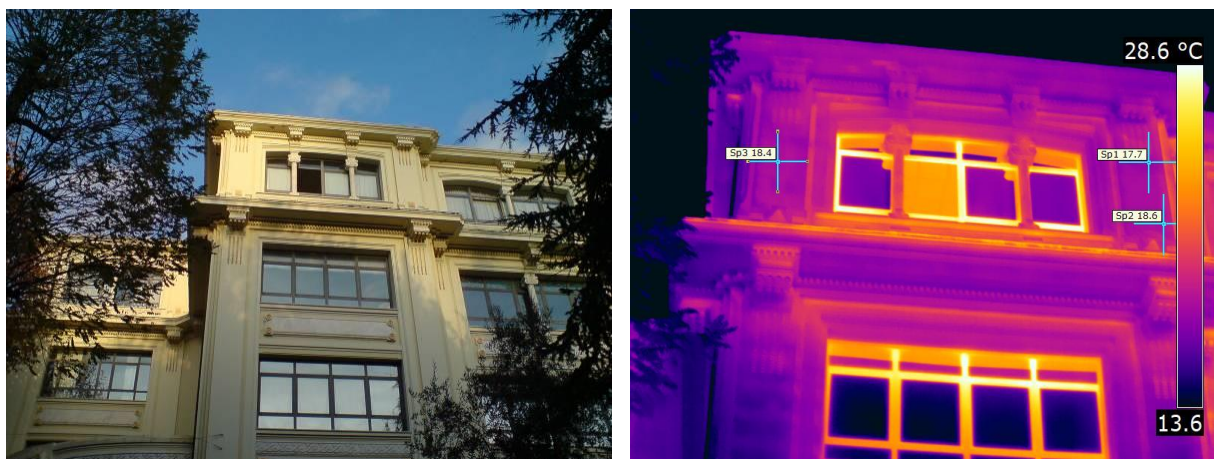
Figura 4.5 – Rilievo termografico dei serramenti al piano secondo e terzo sul fronte principale
